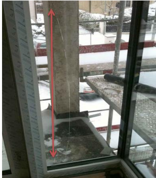
Slika 13.1.5., Izo jedinica ostakljena u jesen prije zime; U zimi, ekstremne hladnoće u negrijanim zgradama u kojima dođe do pod tlaka unutar izo jedinice koji je u ovom slučaju loma povezan i sa iznimnim lošim omjerom u dimenzijama
