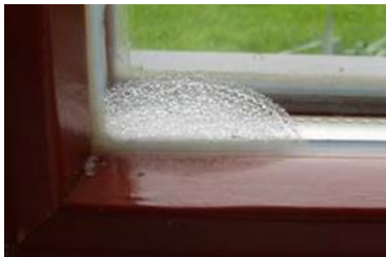
Slika 11.4.1., Oštećenje nastalo posljedicom prolaska vode
