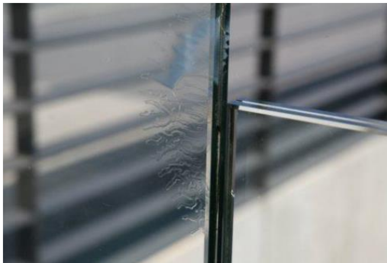
Slika 8.1.1., Delaminacija i zamućenost stakla
