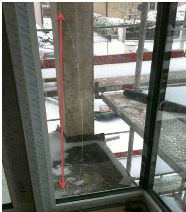
Slika 10.2.5., Izo jedinica ostakljena u jesen prije zime; U zimi, ekstremne hladnoće u negrijanim zgradama u kojima dođe do pod tlaka unutar izo jedinice koji je u ovom slučaju loma povezan i sa iznimnim lošim omjerom u dimenzijama
